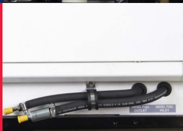
Entrada/Saída do cano de combustível
